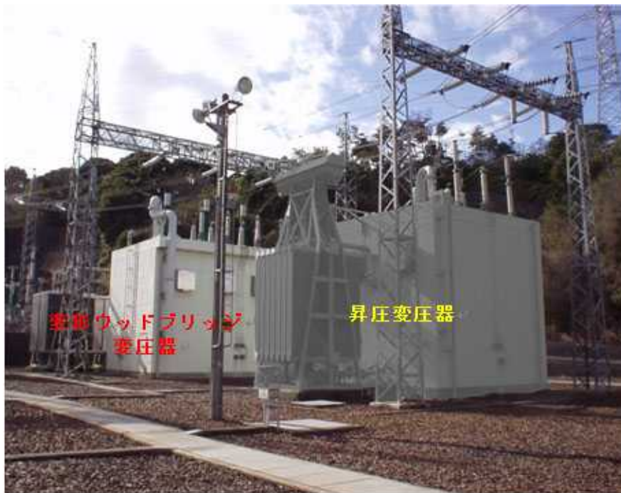
図-2 変形ウッドブリッジ変圧器の外観（従来型）
